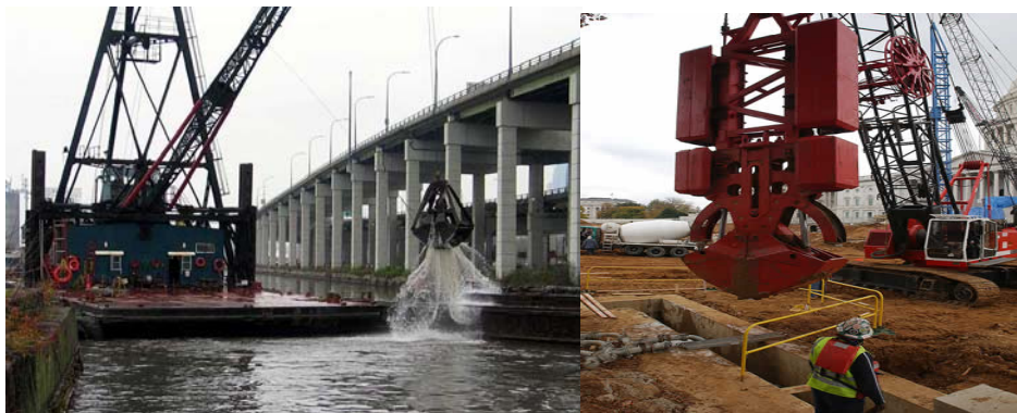
شکل (الف-۸-۱۲) کلامشل در حال عملیات در خاک شکل (ب-۸-۱۲) کلامشل در حال عملیات لایروبی
