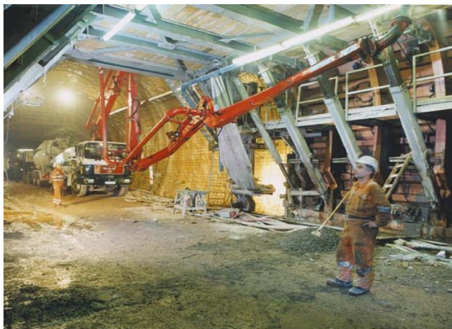
شکل ۴-۱۰-۷- پمپ بتن تونل
