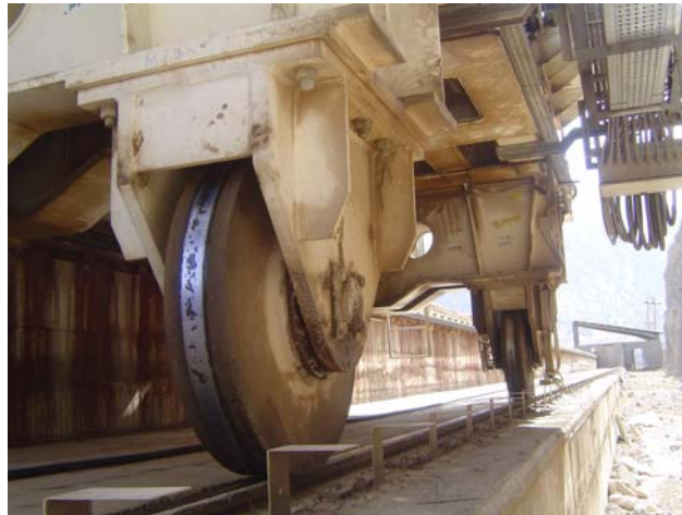
شکل شماره ۶-۶-۸- چرخ‌های واگن سیار جرثقیل کابلی
