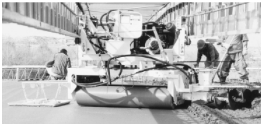
شکل ۴-۱۶-۹- سیلندر فینیشر، در سمت راست تیغه پخش بتن و سمت چپ صفحه پرداخت
