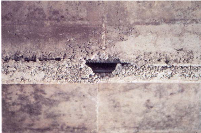
شکل ۸ نمونه‌ای از نحوه نامناسب تراکم بتن
